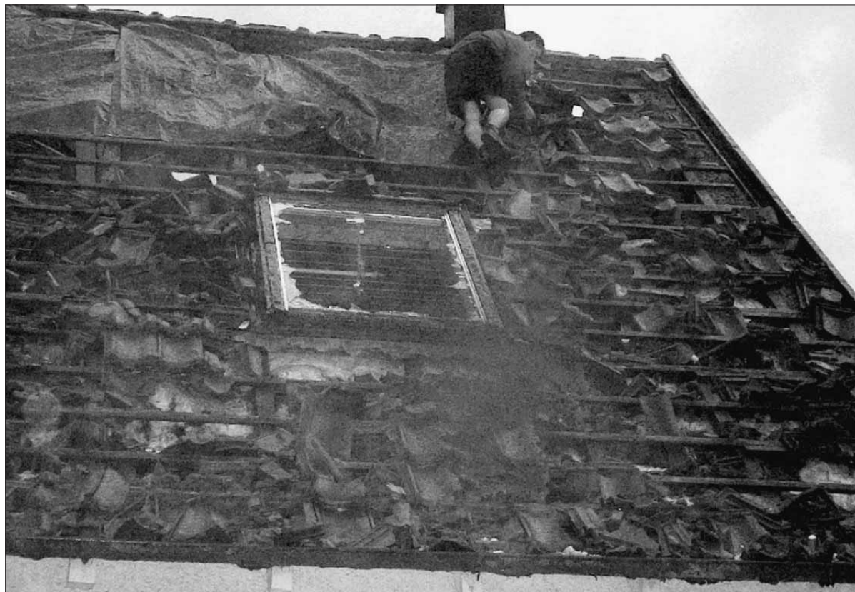
Der Hagelsturm deckte dieses Dach in der Nähe des alten Dr.-Karl-Hohner-Heims komplett ab. Foto: Hochheuser
