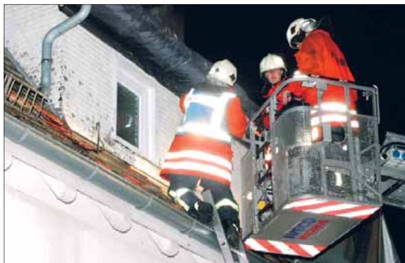
Arbeit in luftiger Höhe: Drei Feuerwehrmänner, zwei von ihnen im Korb einer Drehleiter, arbeiten auf dem zerstörten Dach eines Hauses.
