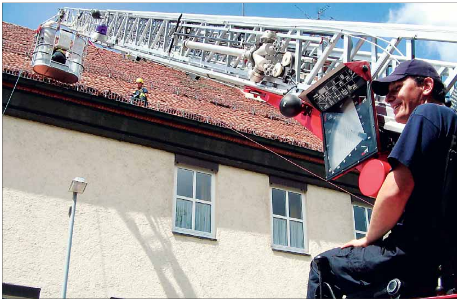
Das Dach der Trossinger Friedensschule ist bei dem Hagelsturm am Mittwochabend wie hunderte andere Dächer zerstört worden. Das Gebäude ist so in Mitleidenschaft gezogen worden, dass die Schule vorerst für den Unterricht geschlossen bleibt. Foto: Michael Hochheuser
